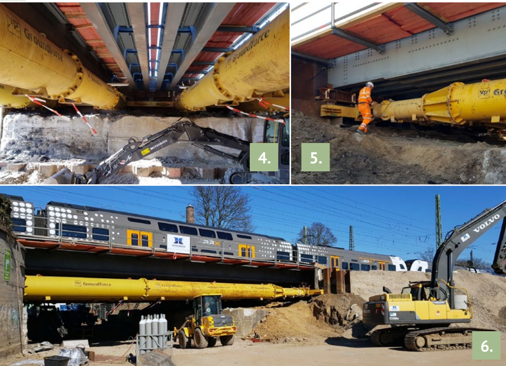
Bild 5: Die Brückenköpfe wurden mit MP250 ausgesteift. Sie hält hohen Belastungen bis zu 250 Tonnen stand und besteht aus einer Hydraulikeinheit und mehreren festen Stahlverlängerungen. Bild 6: Die Steifen werden mit den an den Endplatten angebrachten Typ Konsolen am Gurt angeschlossen und mit Ketten gesichert. Bild 7: Die Steifen und Gurtungen von Groundforce ermöglichen einen schnellen Ein- und Ausbau. Dies ist ein besonders wichtiger Vorteil bei Projekten, welche die Infrastruktur betreffen.
