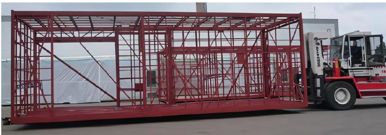
Structure Métallique du modulaire (Source Cadolto)
